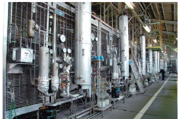
日揮触媒化成(株)の水素化処理パイロットプラント
