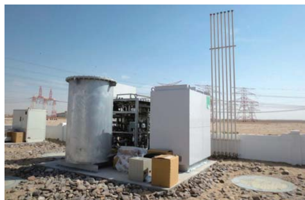
移設したVRU装置 (JX日鉱日石エネルギー(株)提供)
